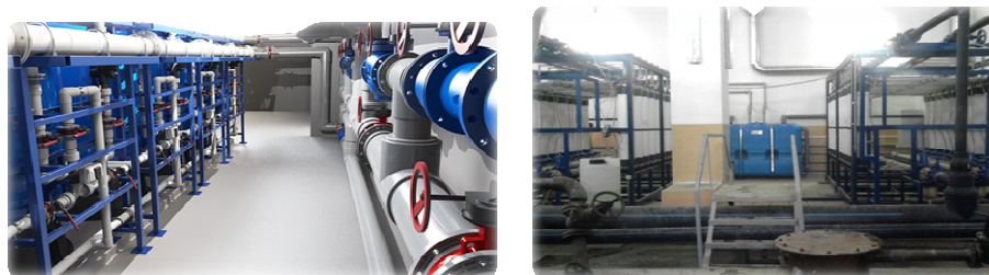
Рис. 3. Станция очистки воды г. Котельниково Волгоградской области производительность 12 000 м 3 /сутки
