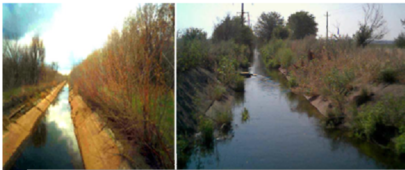
Рисунок 2 – Дефекты каналов оросительных систем
